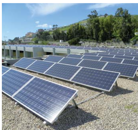
Impianto S.T.E. Energy a Santo Stefano a Mare (IM)
