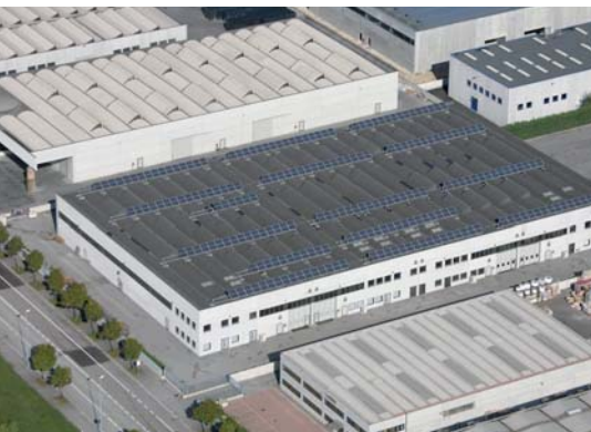
Impianto S.T.E. Energy a Padova
