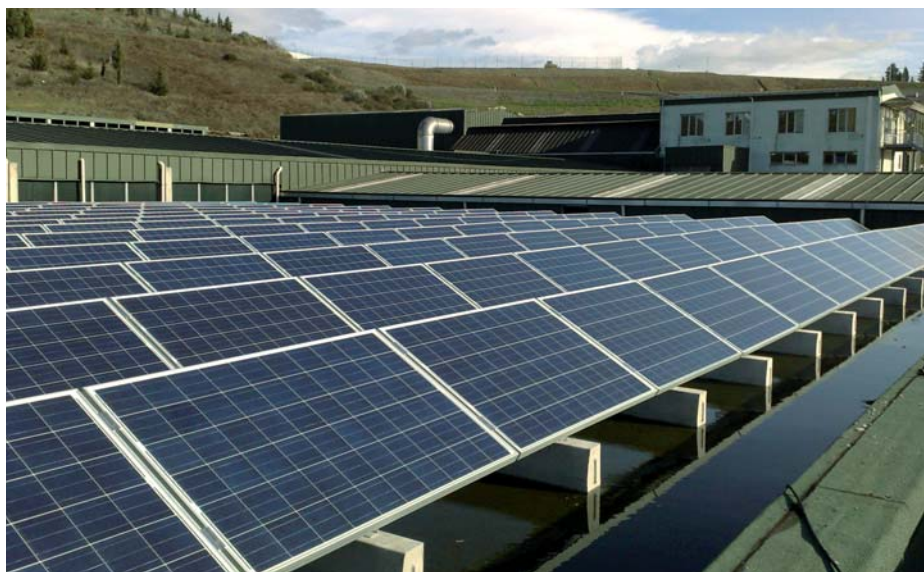
Impianto S.T.E. Energy a Montespertoli (FI)
